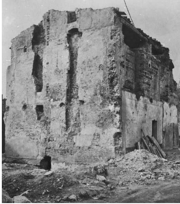
5 Pisae (Pisa). Terme di Nerone. La sala ottagonata durante i lavori di abbattimento degli edifici moderni nel 1940 (SBAAAS-PI, 157645, da Pasquinucci, Menchelli 1989, fig. 43).
